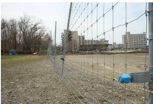
写真 8. ウトロ市街地を囲むように設置されたヒグマ・シカ侵入防止用電気牧柵付きフェンス
